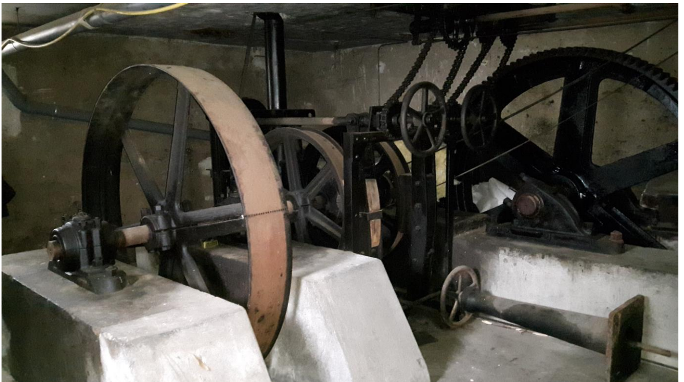
La machinerie du Funiculaire, sous-sol de la gare haute, en 2016
